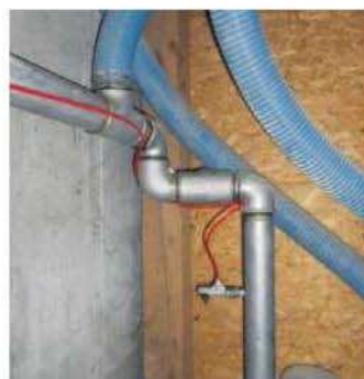
Der Stickstoff wird durch die rote Kunststoffleitung in das Gasausgleichssystem und somit in die Siloanlage befördert.
