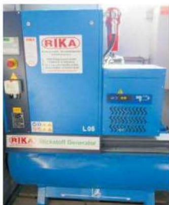
Die Anlage liefert nach Bedarf Stickstoff und verhindert den Zutritt von Luftsauerstoff in den Silo.
